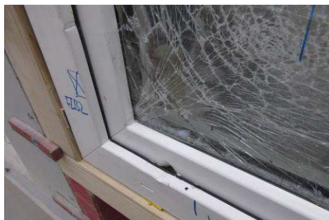
Bild 13 Schäden aus der manuellen Prüfung am Ecklager
