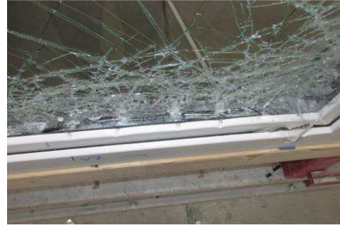
Bild 16 Schäden aus der manuellen Prüfung der Glasanbindung
