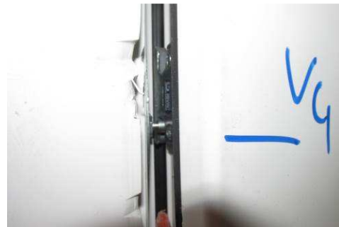
Bild 12 Schäden aus der manuellen Prüfung auf der Griffseite oben
