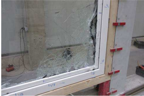
Bild 15 Schäden aus der manuellen Prüfung der Glasanbindung
