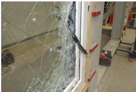
Bild 17 Schäden aus der manuellen Prüfung der Glasanbindung
