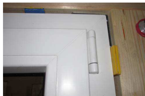
Bild 8 Scherenlager des Probekörpers
